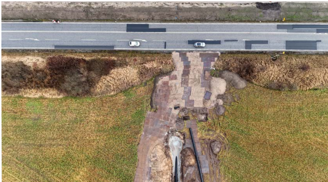
Vestforbrændings største rør blev lagt under Hillerød motorvejen ved hjælp af styret underboring.
